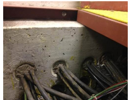
Conduit Putty may contain asbestos
